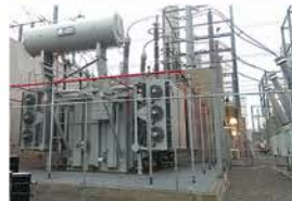
345kV 610MVA 大容量升压 变压器落户美国纽约曼哈顿金融街
