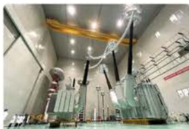
850kV 400MVA三相风冷 强迫油循环试验变压器
