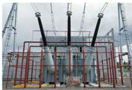
新能源风力发电汇集站大基地 500kV 1000MVA 三相一体超高压变压器
